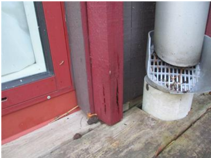
Röta i fönsterfoder samt trasig lövrens
