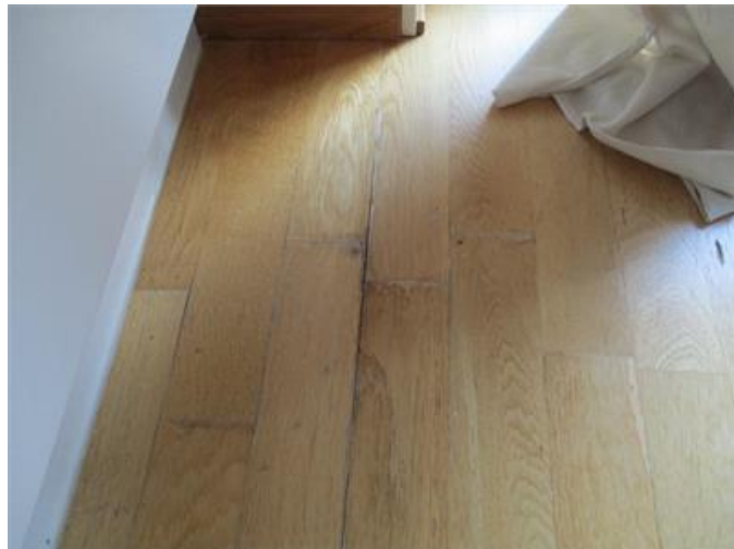
Fuktskadat parkettgolv framför altandörr
